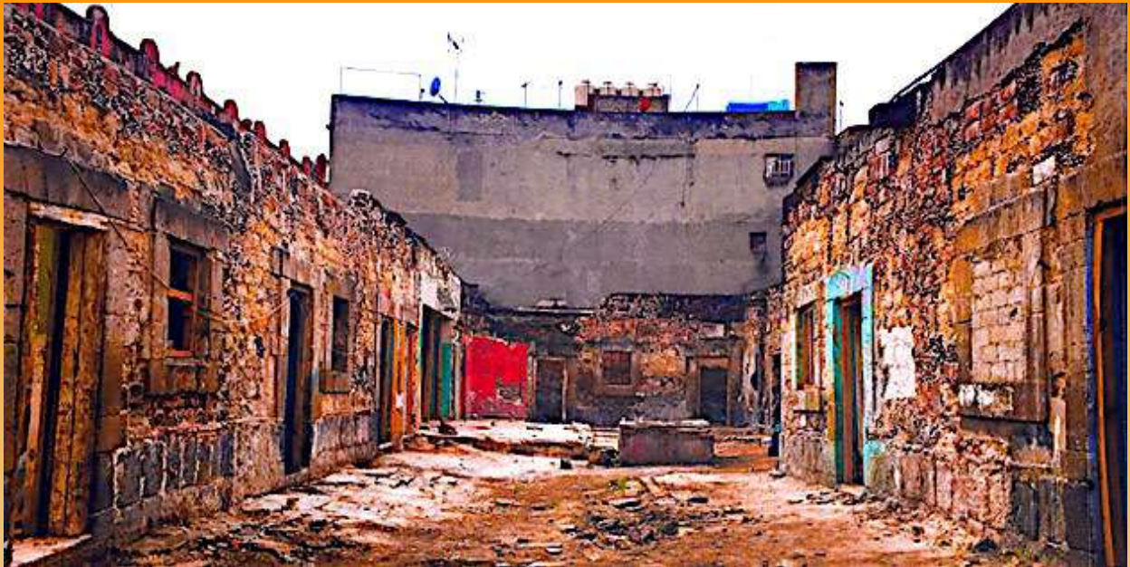
Estado de deterioro casa Manzanares No. 25. Cortesía INAH/foto BRL Héctor Montaño
