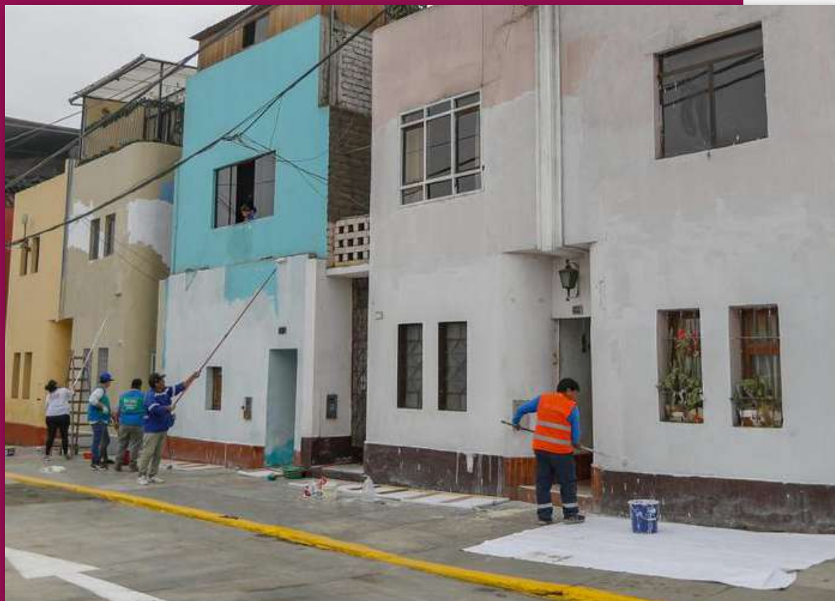
Un ejemplo de rehabilitación es el barrio de Monserrat, en donde se pone en prueba el fachadismo arquitectónico sin importar el interior de las construcciones y viviendas. Fotografía: acervo de la Municipalidad de Lima.
