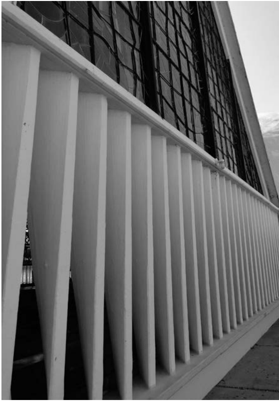
Detalle de la celosía que se inserta en las fachadas laterales del santuario, 2015. Foto: Ivan San Martín.
