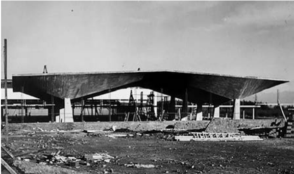
Auditorio de la Facultad de Ingeniería en construcción, Universidad de San Carlos (USAC), Guatemala, 1957. Fotos: Archivo Castillo Gallusser.
