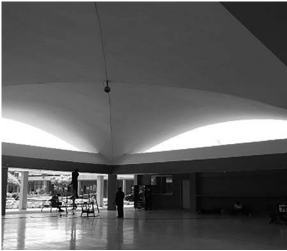
Cubierta del Servicio Nacional de Aprendizaje (SENA), en Cali. Foto aérea del conjunto y vista actual del interior de una de las bóvedas. Fotos: Archivo particular.
