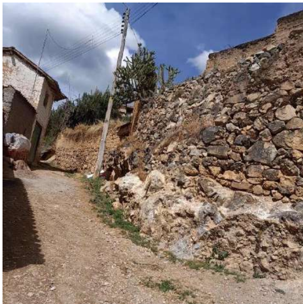
Ilustración 5. Construcción actual de un muro perimetral, nótese la continuidad del sistema constructivo de los períodos anteriores. (foto: Pavel Leiva)
