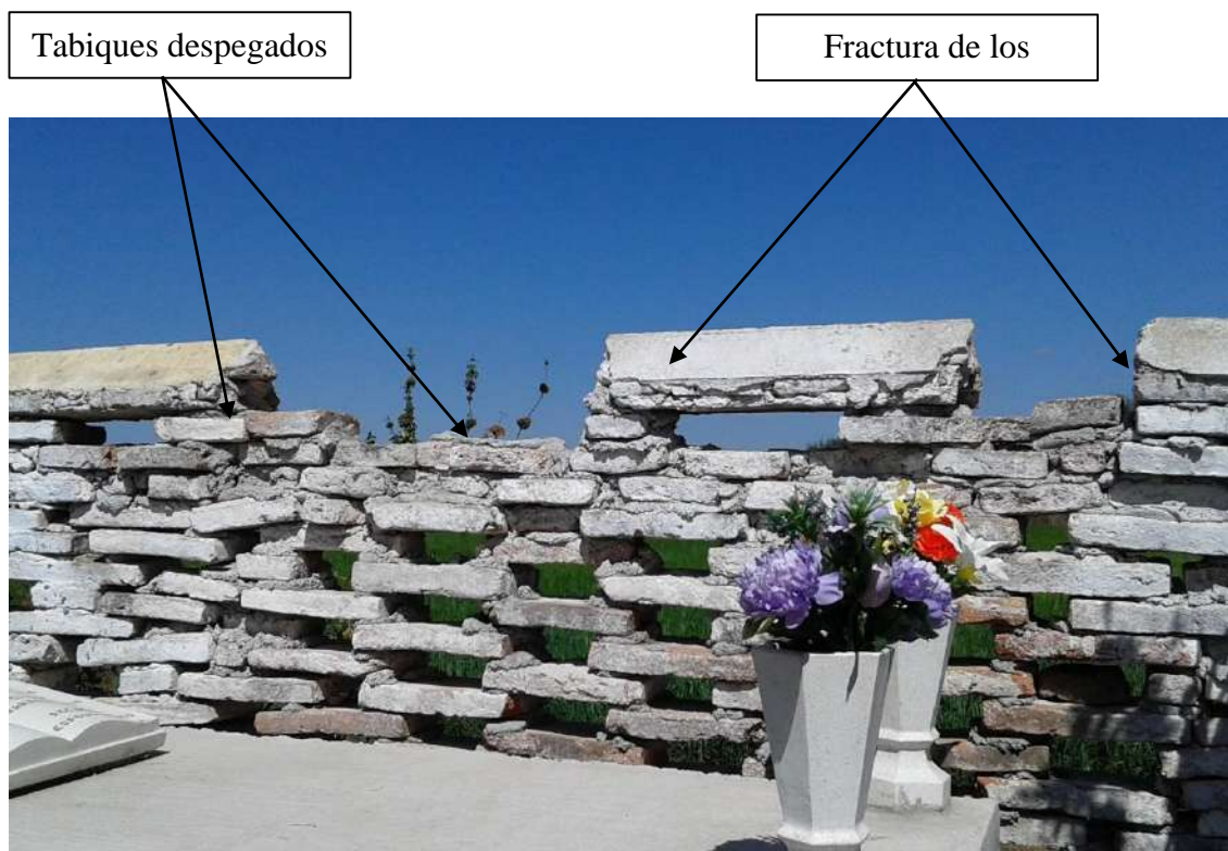
Ilustración 10. Fracturas de celosía de la barda perimetral del Panteón municipal de Jaral del Progreso. Paulina Méndez (2017).
