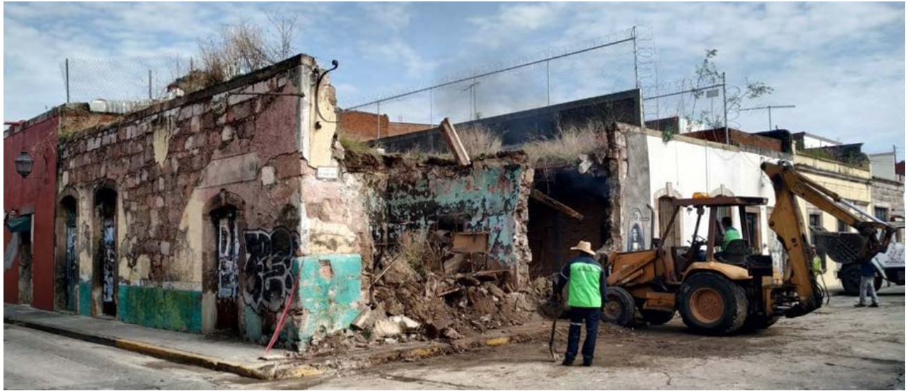
Ilustración 3. Pérdida de inmuebles patrimoniales de uso habitacional en el CHM. Fotografía de C. Barrera (septiembre de 2019).
